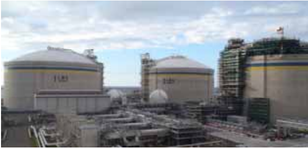
写真1 LNGタンク全景
